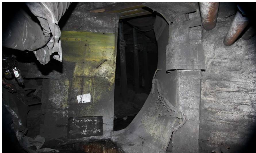
Fot. 8. Uszkodzona przez towarzyszącą eksplozji falę ciśnienia tama wentylacyjna w dowierzchni badawczej I (na jej odcinku zaliczonym do „strefy 0”). Siła działająca na odrzwia tamy, zgodnie z ustaleniami biegłych, wynosiła 40 ton.
