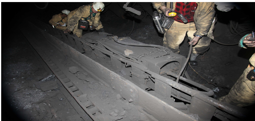
Fot. 12. Jedna z zabudowanych w ścianie 5/409 chłodnic powietrza typu SCP, której stan techniczny w toku oględzin – w szczególności ślady naprawy przewodu zasilającego – wzbudzał podejrzenie, iż mogła stanowić potencjalne źródło inicjału. Późniejsze badania dokonane przez biegłych z KD „Barbara” i „OPA Labor” wykluczyły udział tego urządzenia w zainicjowaniu wybuchu.
