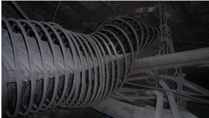
Fot. 6. Widok chodnika w „strefie 0”, ze śladami intensywnego oddziaływania płomieni i przemieszczeniem elementów obudowy w wyniku działania fali wysokiego ciśnienia.
