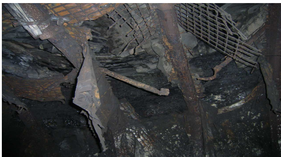
Fot. 9. Zniszczona wskutek działania płomieni obudowa ociosu wyrobiska położonego w „strefie 0” oraz osłabione pożarem stalowe łuki, zwiększające ryzyko zawalenia się stropu, nad którym zalega ponad 1000 metrów skał.
