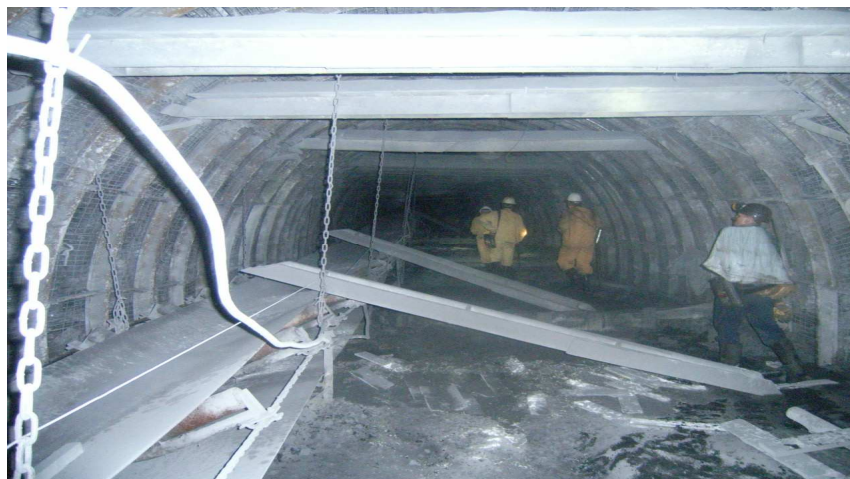
Fot. 3. Częściowo zrzucone półki zapory przeciwwybuchowej pyłowej w wyrobisku położonym w „strefie 2”. Fakt zrzucenia tylko kilku półek zapory świadczy o tym, że dochodząca do tego miejsca fala wysokiego ciśnienia była już znacznie osłabiona.
