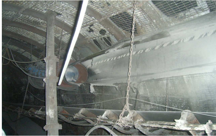
Fot. 4. Widok wyrobiska w „strefie 1” ze śladami intensywnego działania płomieni na elementy wyposażenia i obudowy.
