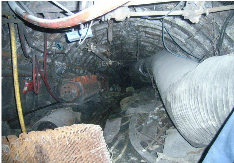
Fot. 2. Widok chodnika w „strefie 2”, ze śladami działania fali wysokiego ciśnienia, bez śladów oddziaływania płomieni.
